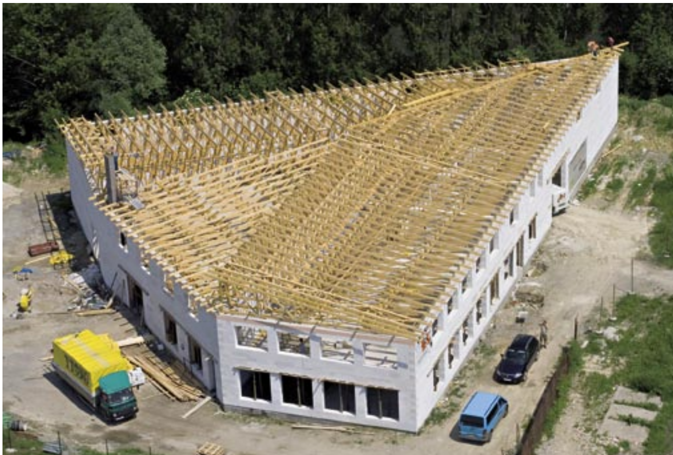
Nosná konštrukcia stropu a strechy výrobnjej haly zostavená z drevených priehradových väzníkov od spoločnosti Kontrakting stavebné montáže, s. r. o.
