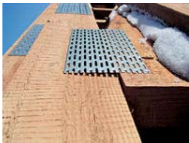
Nepripustná tolerancia v hrúbke jednotlivých prvkov väzníka
